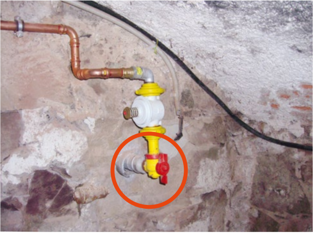
Mögliche Radon-Eintrittspfade in einem Keller an Leitungsdurchführungen und über das Mauerwerk Quelle: Staatliche Betriebsgesellschaft für Umwelt und Landwirtschaft
